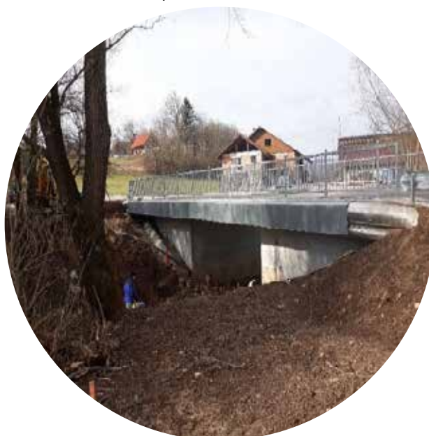
Vodovod preko mostu Črna mlaka
